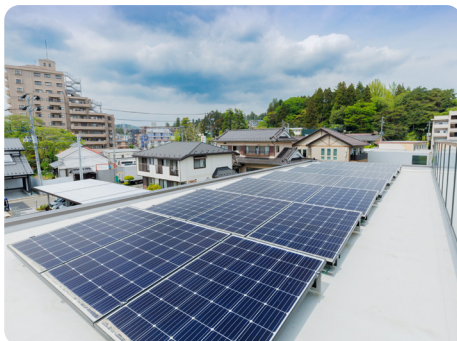
太陽光パネル
